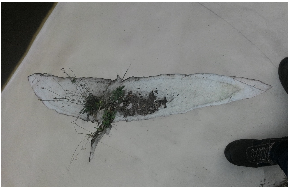
Foto n. 8 – Particolare del degrado del telo impermeabilizzante e del geotessile sottostante sul paramento
