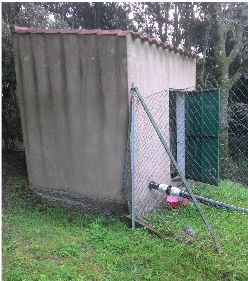
Foto n. 10 – Locale di servizio con particolare condotta di aspirazione acqua dall'invaso
