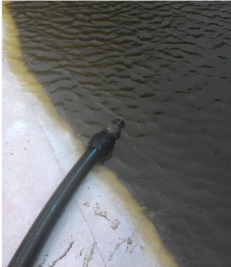
Foto n. 14 – Pigna di aspirazione per alimentazione impianto a servizio delle fasce umide
